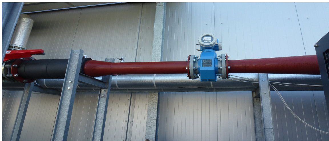
Rys.1. Instalacja przepływomierza elektromagnetycznego na rurociągu głównym (fi 250) układu chłodzenia
