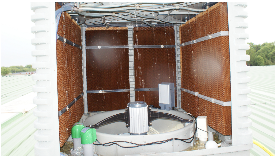
Ryc.1 Indywidualny układ bezpośredniego chłodzenia wodą zabudowany na czepni powietrza
